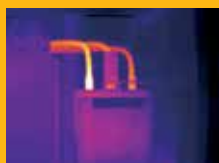
Špatná spojení a vnitřní poškození
